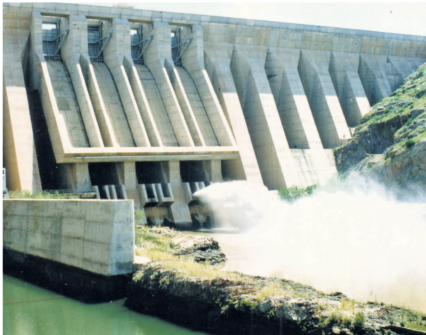
Le barrage Al Massira est le 2e grand ouvrage du pays après Al Wahda. D'une réserve théorique de 2,6 milliards de m 3 et d'une hauteur de 133 mètres, il a été construit en 1975 dans la région de Chaouia-Ourdigha. Ses eaux irriguent également une partie des Doukkala (Ph. L'Economiste)
