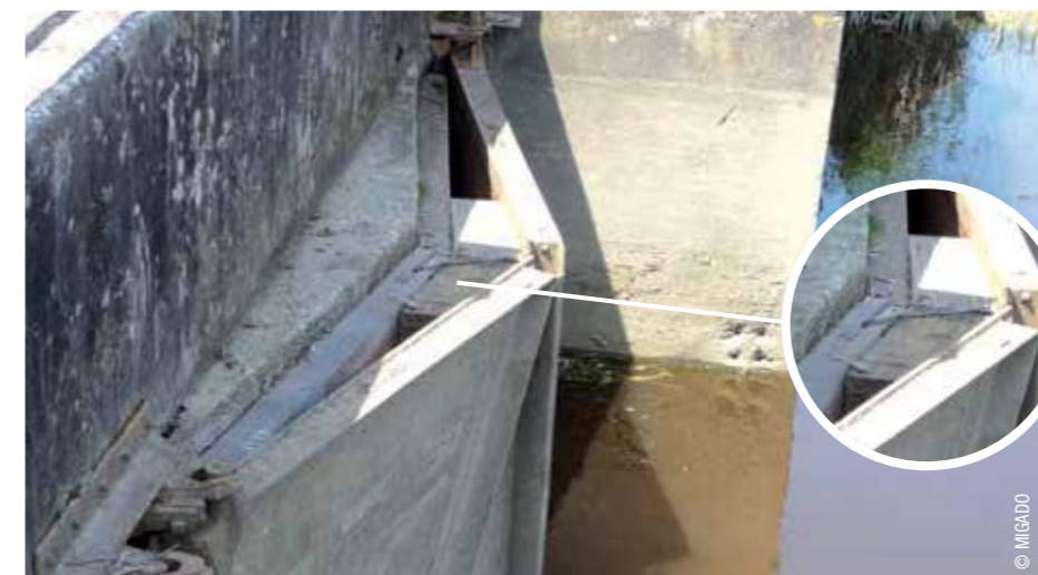
Cales empêchant la fermeture des portes sur un affluent de la Gironde
